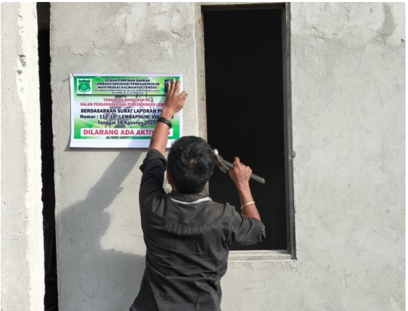
Gambar: Bangunan BTN Yang Dibangun Oknum D Di Segel Untuk Dilarang Ada Aktivitas Sementara
